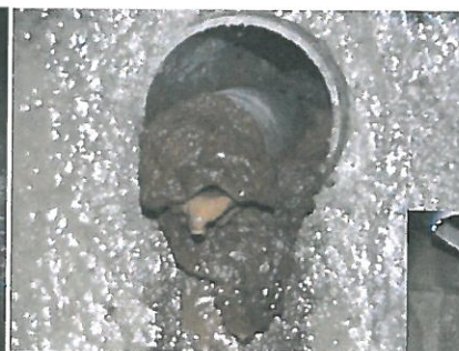
▲写真-4 集水管の閉塞状況
